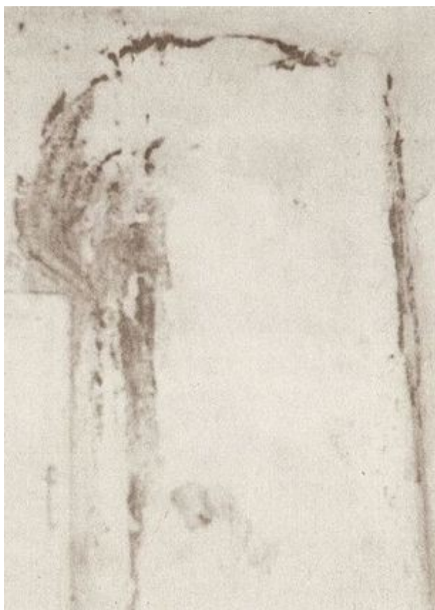
Ściana w przedpokoju mieszkania. O remoncie nie ma co myśleć. Zdjęcie wykonane latem 1986 roku.
